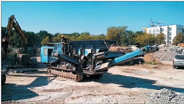
Fig. 2. Crusher Rys. 2. Widok kruszarki
